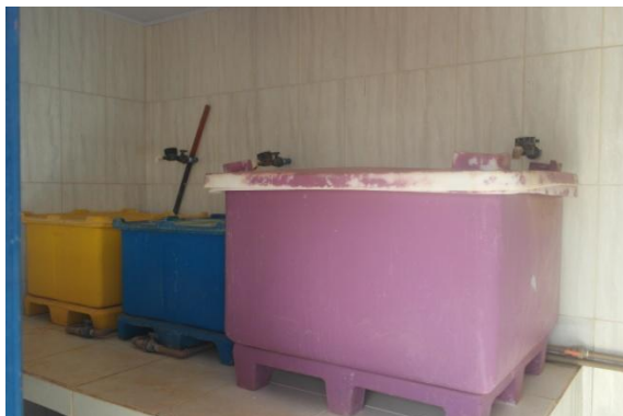
a) reservatórios de produtos químicos
