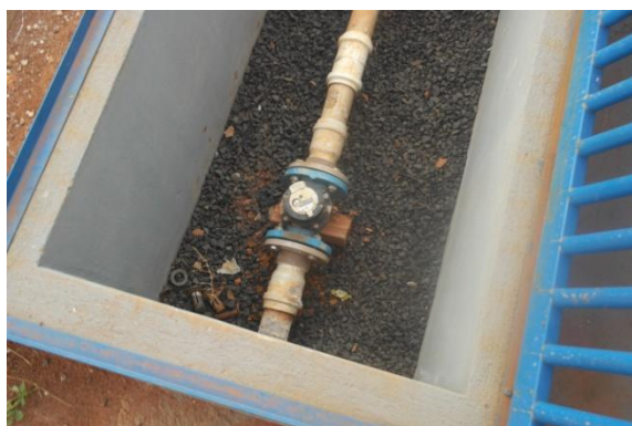
a) Macromedidor na tubulação de chegada do REL
