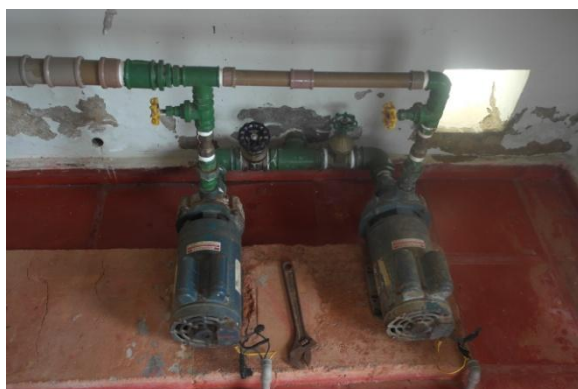
c) Conjuntos moto-bomba de recalque de água
