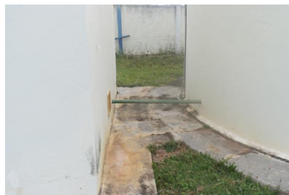
d) Tubulação de sucção do RAP para o CMB
