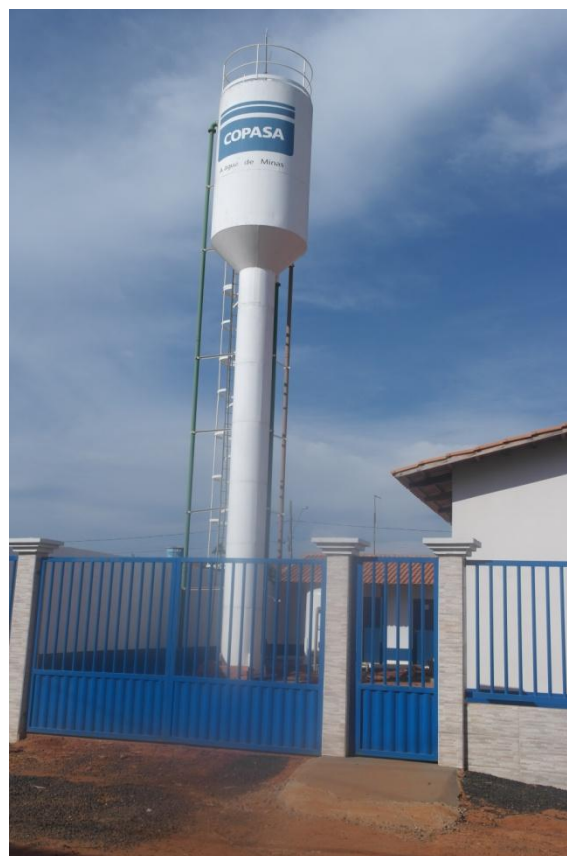
c) REL entrada (1) e saída (2) de água
