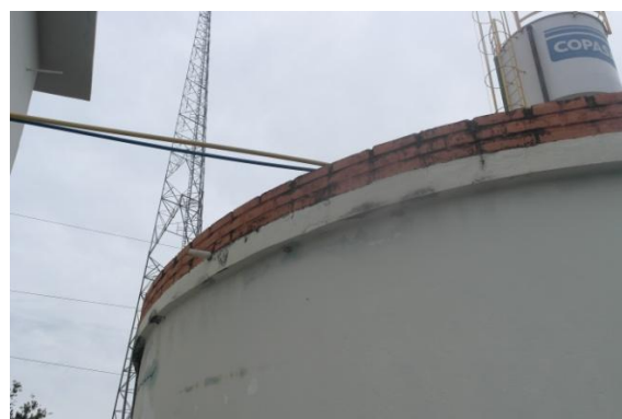
8d) Ponto de injeção de produtos químicos no RAP
