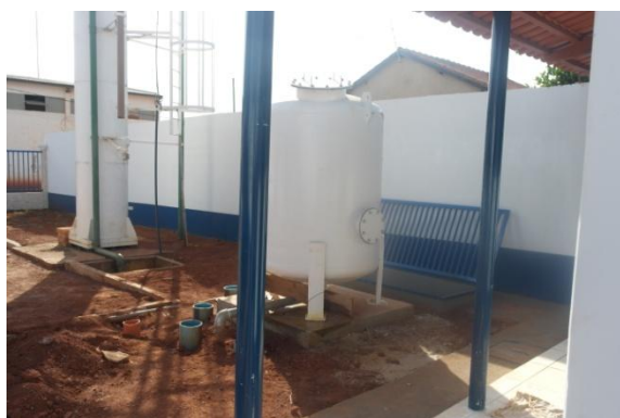
b) Filtro de pressão à montante do REL
