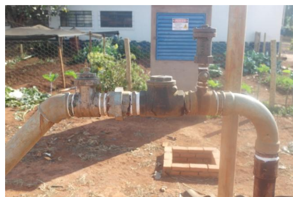
b) componentes da tubulação de recalque junto
