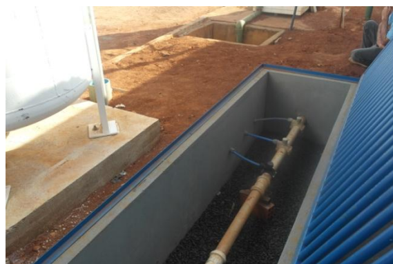
d) Injeção dos produtos químicos na linha de recalque
