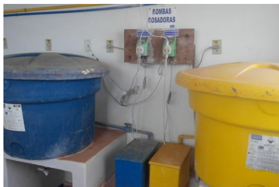
8a) Reservatórios e bombas dosadoras
