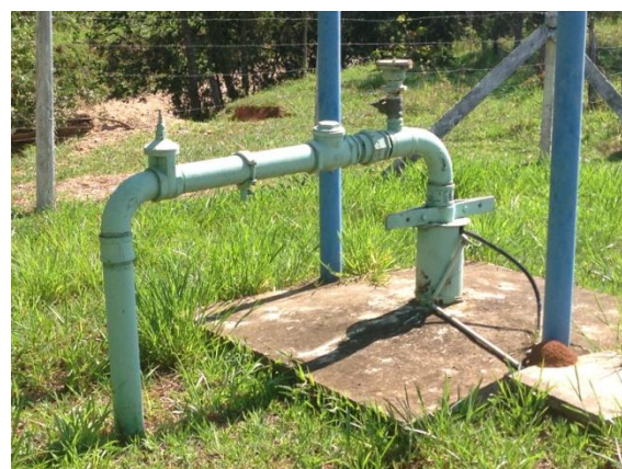
3b) Componentes da tubulação de recalque
